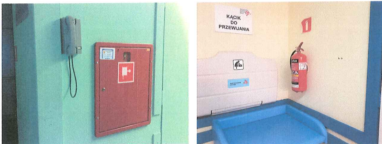
Usytuowanie hydrantu wewnętrznego i gaśnicy proszkowej
